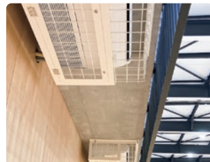
天井に設置された室内ユニット
