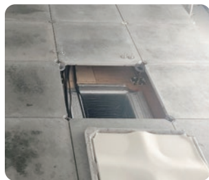
床吹き出し空調 (フロアタイルの目地にあたる部分が すべて吹き出し口になっている)
