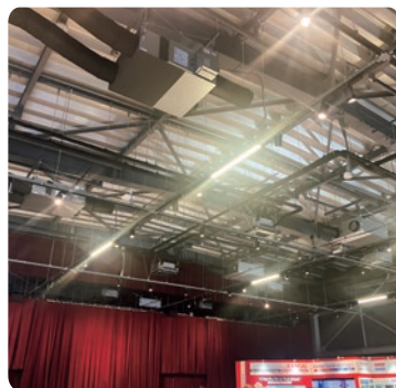
フェスティバルステーションの空調配管をむき出しにしたスケルトン天井
