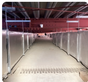
カーボンニュートラルを考慮し ダンボールダクトを採用
