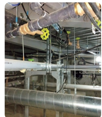
来場者の快適さを支えるピット内の配管
